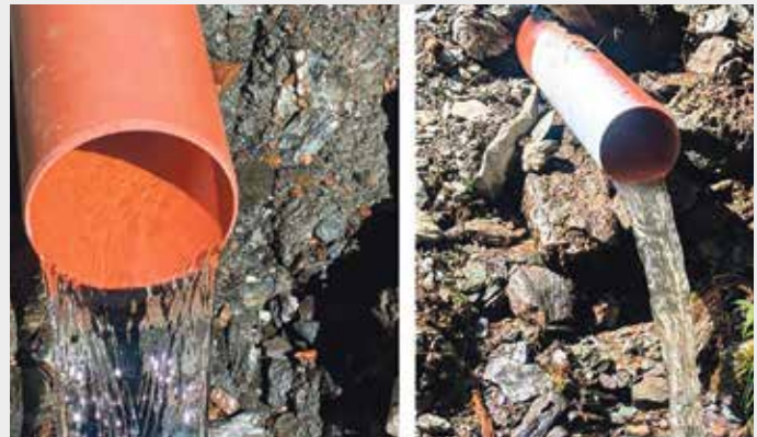
Aus den 200 Rohren treten zusätzlich jeweils rund 5 Liter Quellwasser pro Sekunde aus – wertvolle Wasserreserven für die Zukunft
